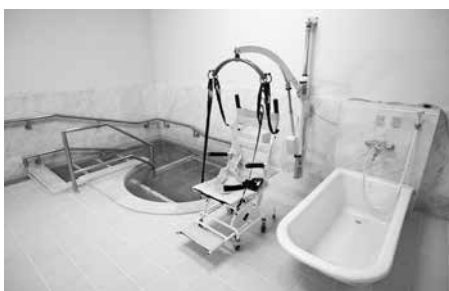
小浴室Aのリフト
