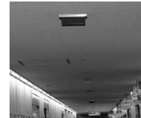
天井部分にパトライト（客室・浴室・廊下等に設置）
